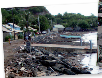
Mur déchaussé par l'érosion à Majicavo Koropa.
